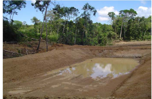
Zona donde se construyen los estanques de la Estación Experimental Acuicola y Agroforestal.
