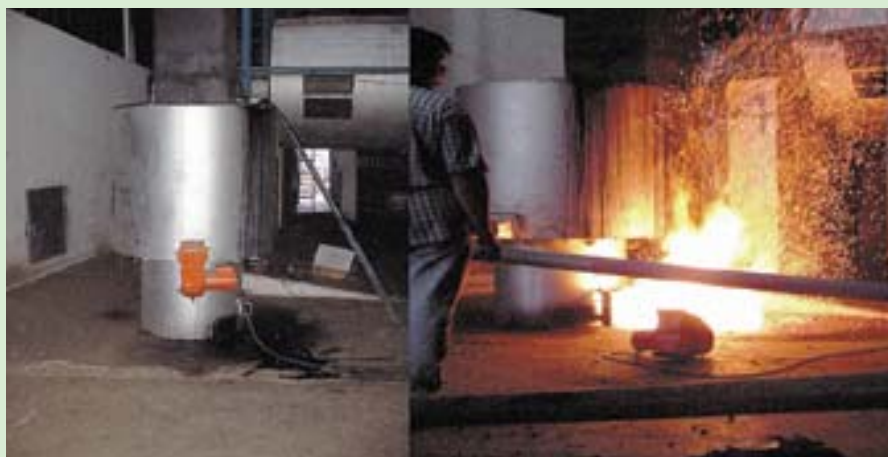
Figura 13a. Gasificador instalado en Coopetila, Guanacaste.
