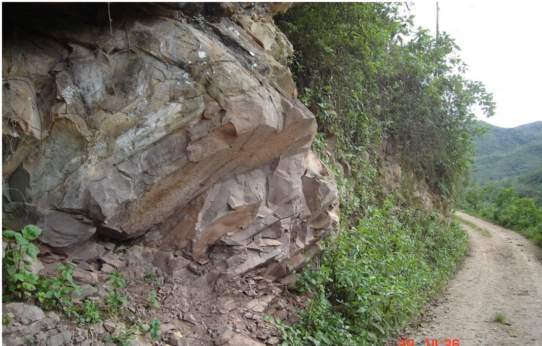
Foto 13: Afloramiento de volcánicos piroclásticos muy alterados, fuertemente fraturados. Proximidades de la localidad de Saurayamuro (Tramo Chocanto-Abra Chanchillo), Distrito de Balsas. WC 2005.
